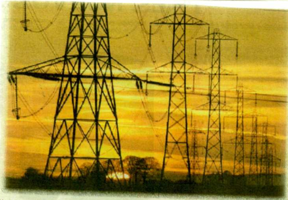
Una torre eléctrica es una estructura de gran altura, cuya función principal es servir de soporte de los conductores eléctricos aéreos de las líneas de transmisión de energía eléctrica. (SEP)
